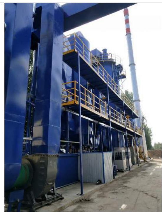
旋风分离+过滤器+冷凝+电捕油+冷凝 +UV 光氧催化装置
