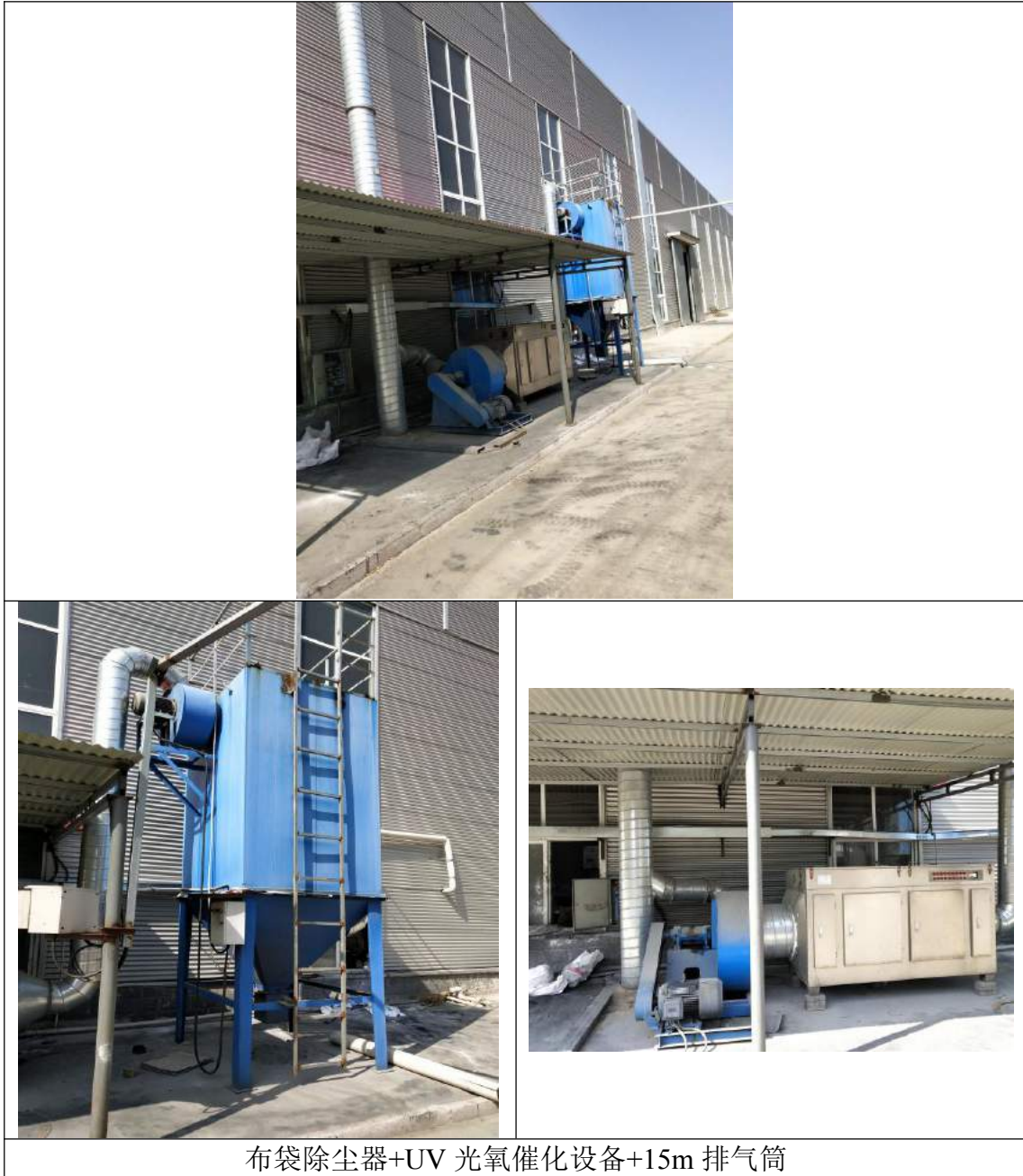
图4-3 废气治理措施
