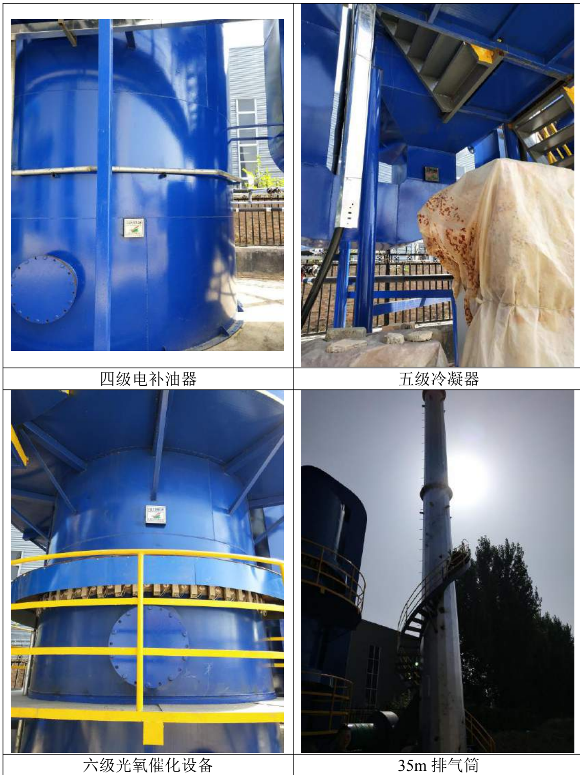
图4-1 废气治理措施
