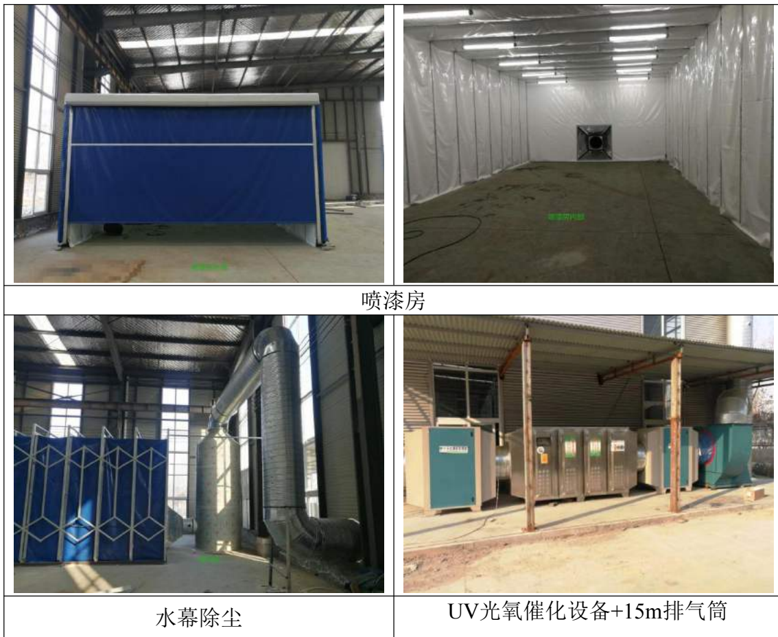
图4-4 废气治理措施
