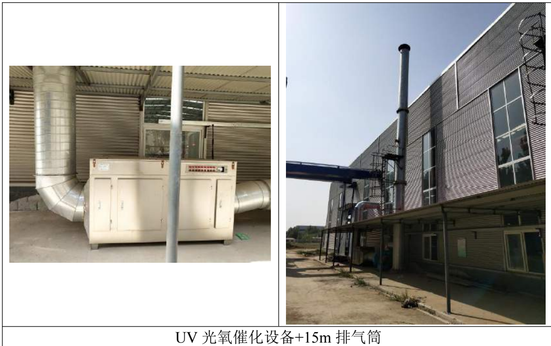
图4-2 废气治理措施
